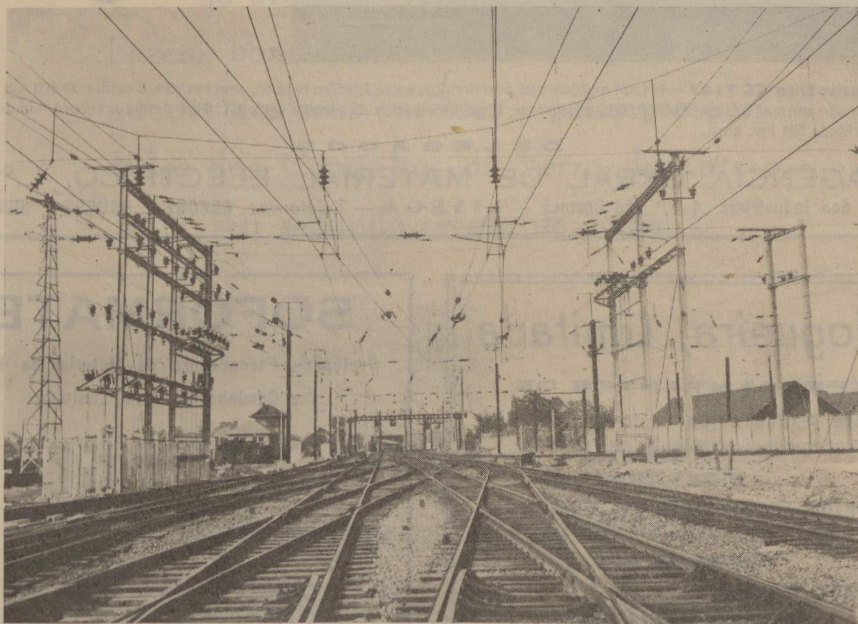
Electrificação S. N. C. F. - 25.000 Volts — Thionville - Valenciennes — Entrada da estação de Thionville vista da subestação alimentadora
